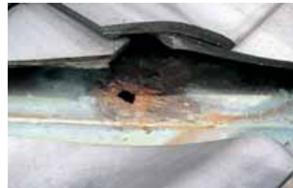
漆喰の剥がれ
