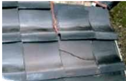
セメントの割れ
